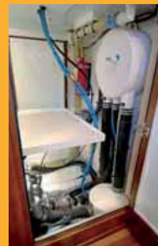
Vano motore con il piano per l'eventuale generatore
